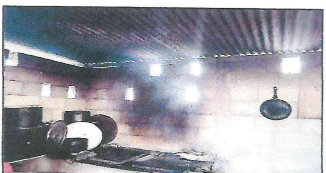
Foto 6: salida de humo de cocina en mal estado, por chimenea destruida
