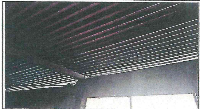
Foto 2: costaneras de techo con corrosión por humedad y humo de cocina
