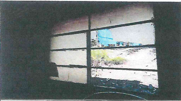
Foto 3: vidrios de ventanas rotos y en mal estado
