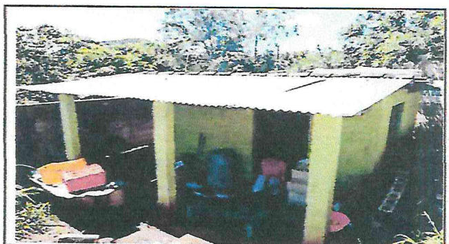
Foto 4: pintura exterior e interior de cocina en mal estado
