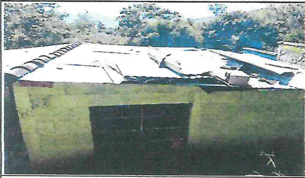
Foto 1: lamina del techo en mal estado con perforaciones y partes rasgadas
